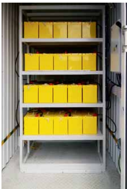
Рис. 3. Стеллаж с аккумуляторными батареями YELLOW
