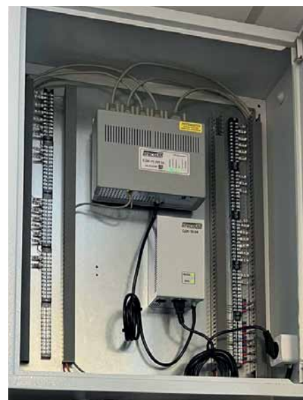
Рис. 2. Блок контроля в распределительном щите диспетчеризации
