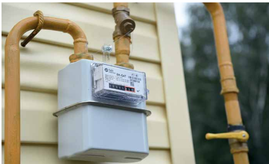
Рис. 6. Счетчик газа ВК, установленный на улице
