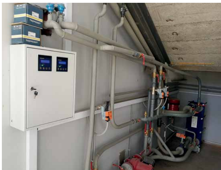
Рис. 3. Регулятор температуры «Термодат-35С5» в котельной
