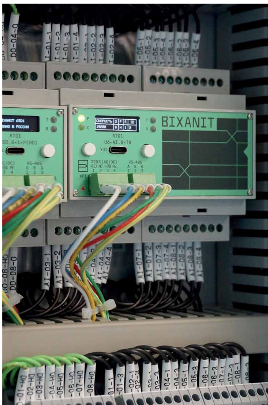
Рис. 2. Модули ввода/вывода BIXANIT ATD1 в шкафу автоматизации
