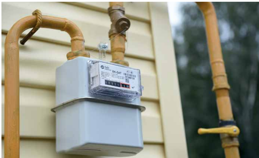
Рис. 6. Счетчик газа ВК, установленный на улице
