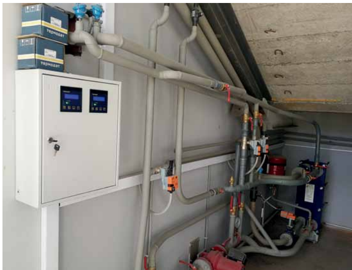
Рис. 3. Регулятор температуры «Термодат-35С5» в котельной
