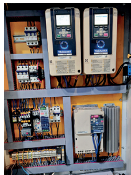
Рис. 1. Электронная коробка подач (ЭКП) в электрошкафу
