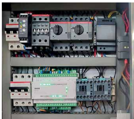
Рис. 4. Программируемое реле ПР102 в шкафу управления холодильной установкой
