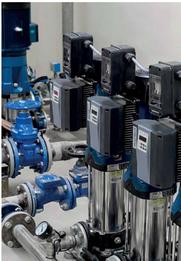
Рис. 3. Установки повышения давления с каскадным управлением в ЖК «Шоколад» (г. Дмитров Московской обл.)
