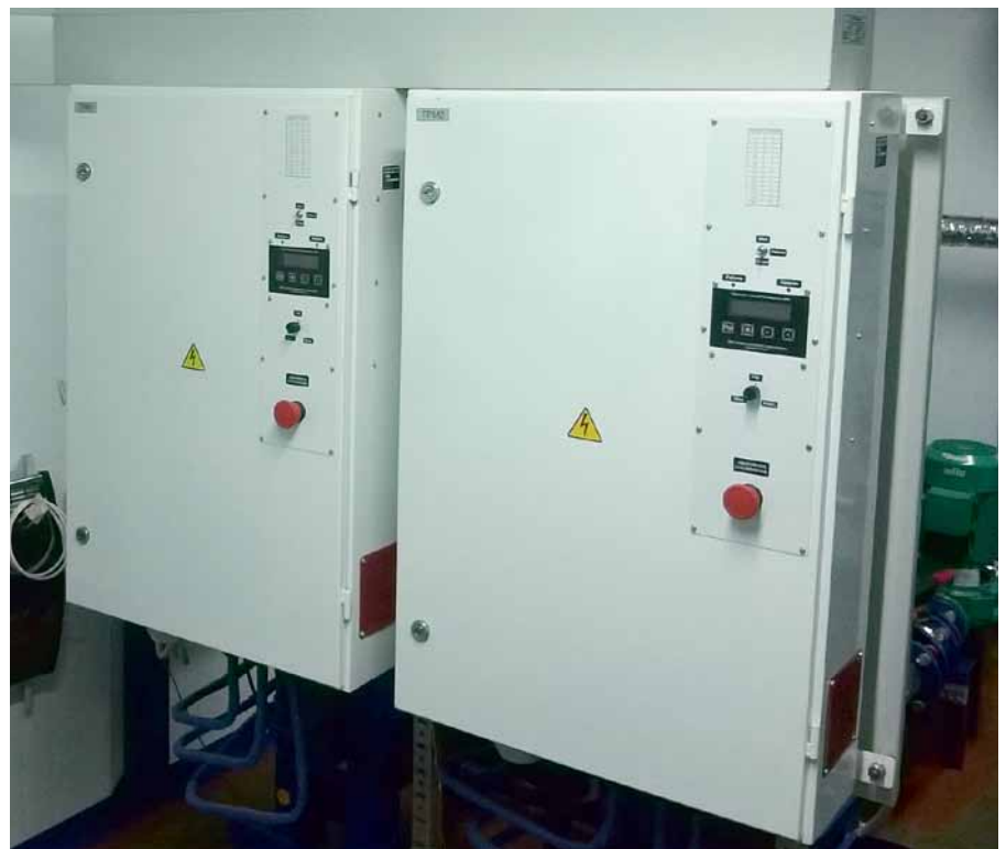
Рис. 1. Тиристорный регулятор переменного напряжения серии ТРМ в котельной
