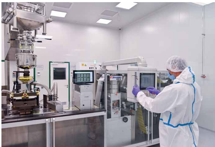
Рис. 1. Чистое производство с установленной системой ГИГРОТЕРМОН
