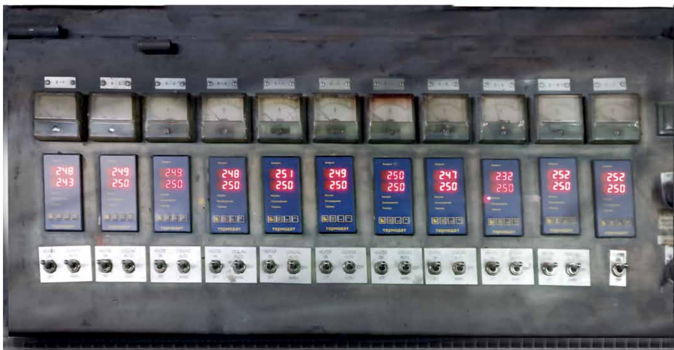
Рис. 2. Щит управления двухшнековым экструдером выполнен из 11 одноканальных ПИД-регуляторов «Термодат-12К6» в вертикальном исполнении
