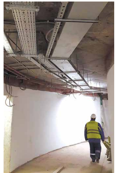
Рис. 4. ОКЛ ELTROS OKLine на объекте ЖКХ
