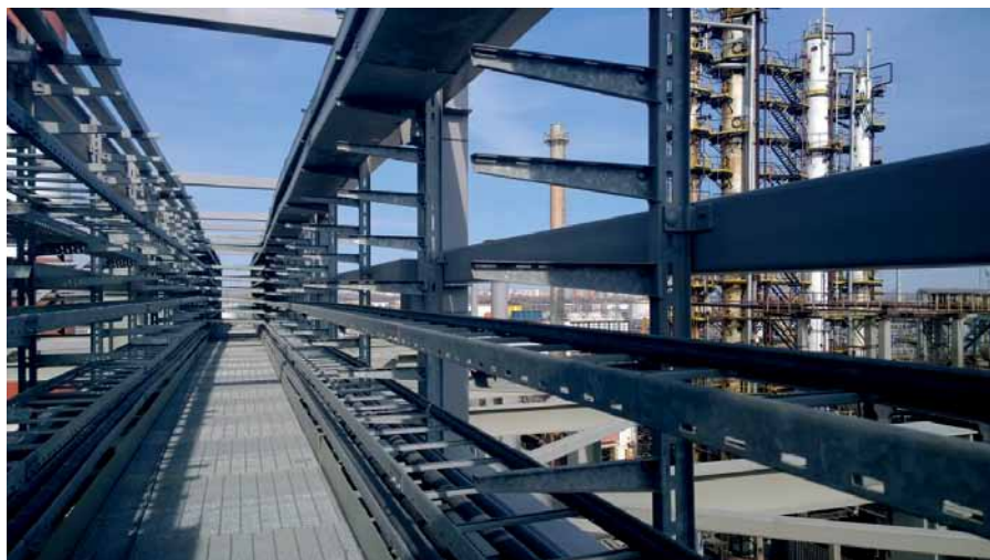
Рис. 2. Кабеленесущие системы «ОБО Беттерманн» на заводе по производству полипропилена в Тобольске «Тобольск-Полимер» (Тюменская обл.)
