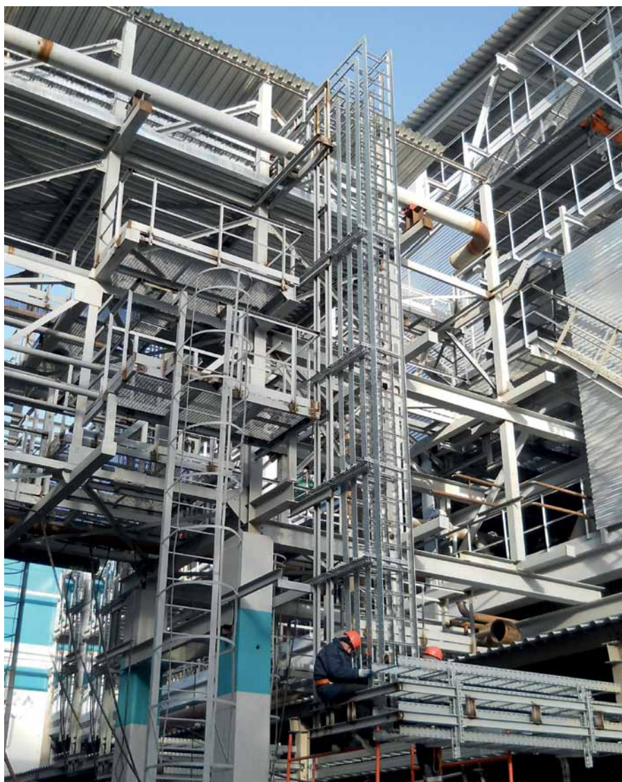
Рис. 3. Кабеленесущие системы «ОБО Беттерманн» на Покровской УКПП Покровского нефтяного месторождения (Оренбургская обл.)
