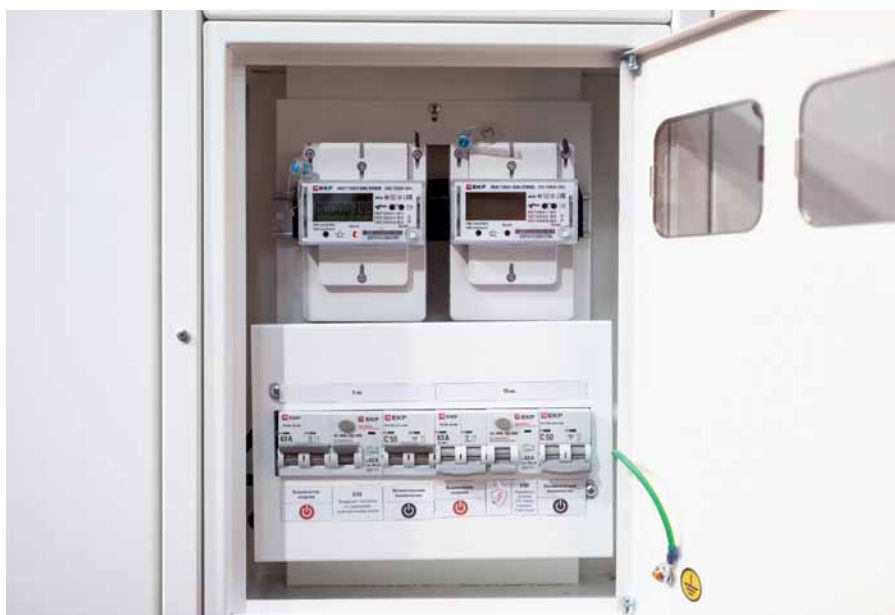
Рис. 3. Электрощит на модульном оборудовании обновленной линейки PROXIMA
