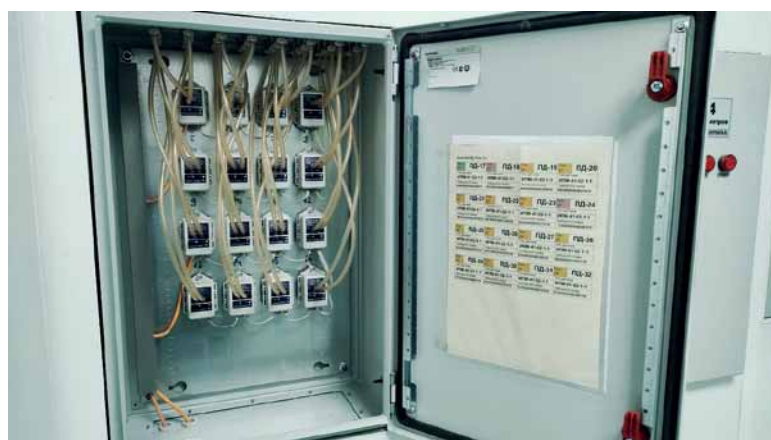
Рис. 4. Шкаф с датчиками перепада давления ИПМ-41-03-1
