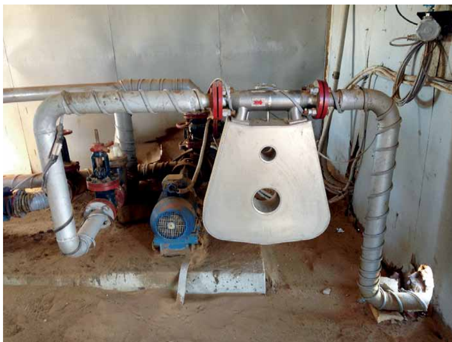
Рис. 2. Кориолисовый расходомер «ЭЛМЕТРО-Фломак», установленный на объекте ООО «ЕвроСибОйл» для учета водонефтяной эмульсии и контроля массы нефтепродуктов при наполнении автомобильных цистерн
