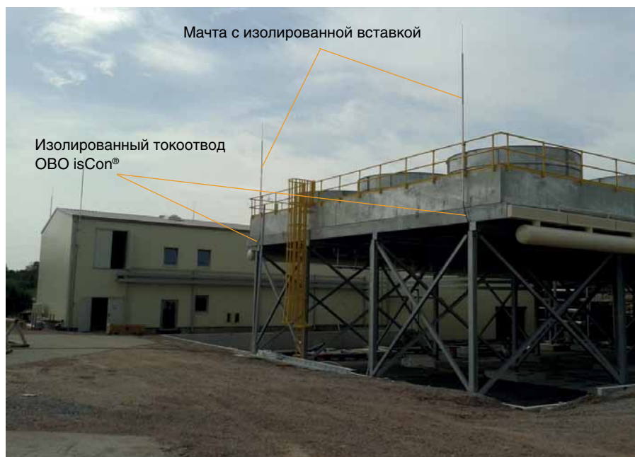
Рис. 3. Пример использования молниеприемных мачт с изолированными вставками и токоотводами OBO isCon® на промышленном объекте
