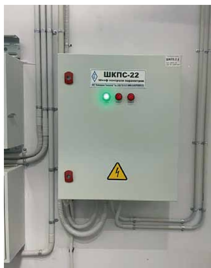
Рис. 1. Шкаф мониторинга микроклимата
