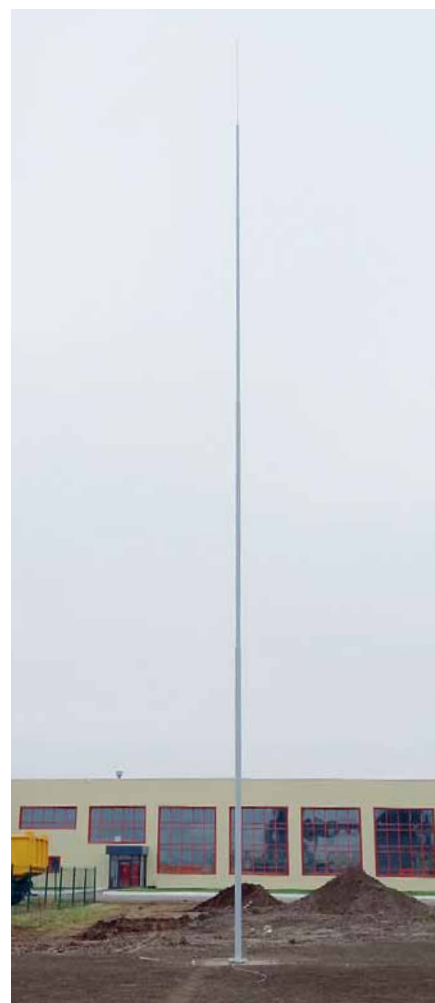
Рис. 1. Молниеотвод: отдельно стоящая мачта на бетонированном основании
