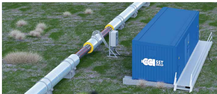
Рис. 2. Система VeLL на трубопроводе
