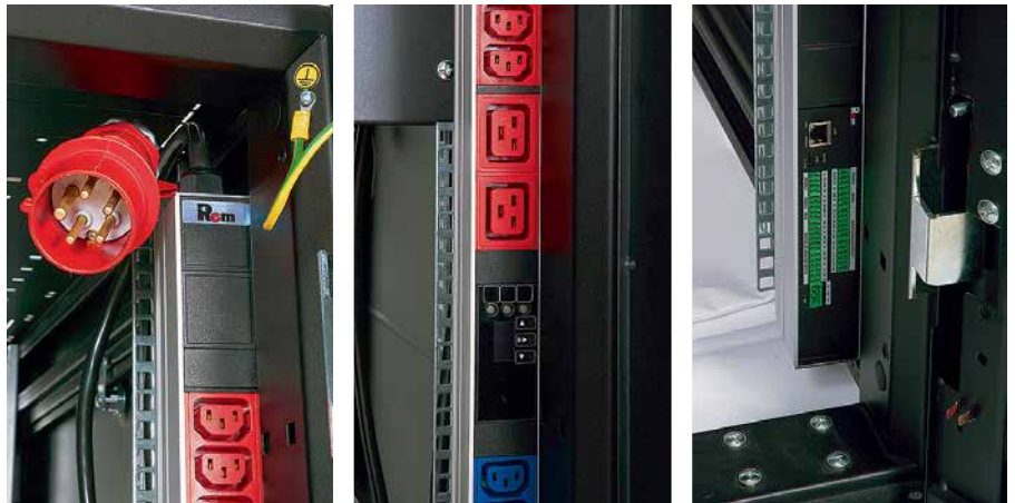
Рис. 1. Интеллектуальный блок распределения питания с измерительным модулем, установленный в шкаф
