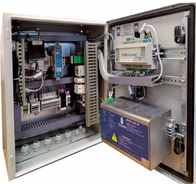
Рис. 3. Шкаф учета и телемеханики для цифровизации электрических подстанций
