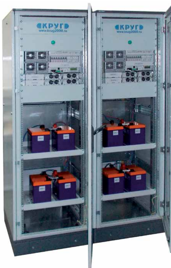
Рис. 1. Шкафы бесперебойного питания
