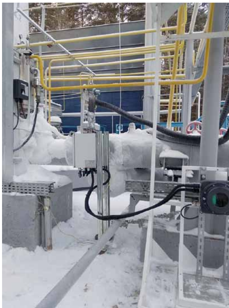
Рис. 3. Комплекс для анализа СПГ на ГРС-4 в ООО «Газпром трансгаз Екатеринбург»
