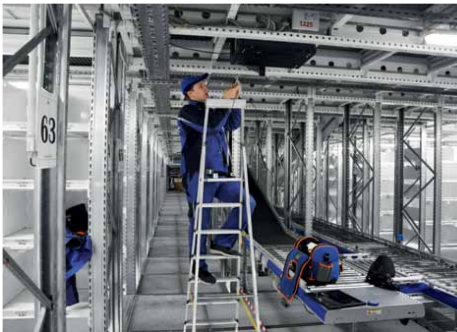
Рис. 3. Внедрение системы мониторинга «СканЭйр Темп ВП» на фармацевтическом складе: установка блока управления
