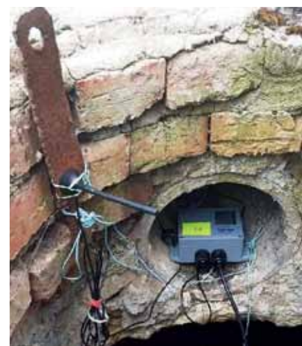
Рис. 6. Узел дистанционного контроля уровня воды в резервуаре на базе комплекта «Ультразвуковой датчик уровня PROMODEM GSM»
