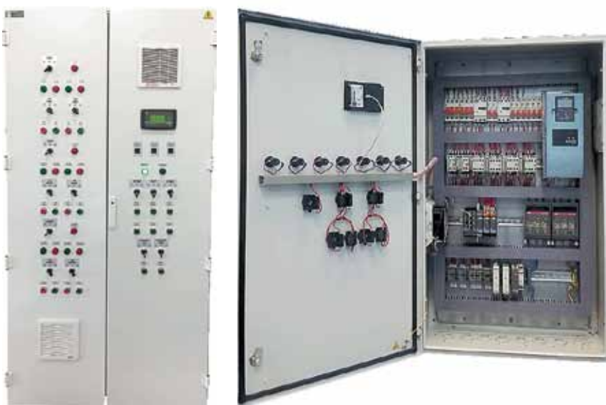
Рис. 2. Щит управления частотным электроприводом ЩУ-УЧП
