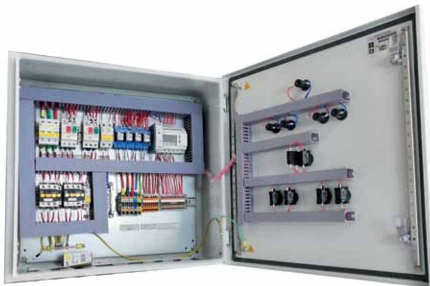
Рис. 1. Щит управления насосами «Оптима»
