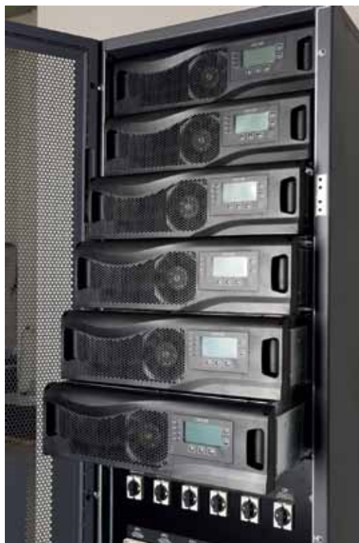
Рис. 2. ИБП 150 кВА без внутренних АКБ
