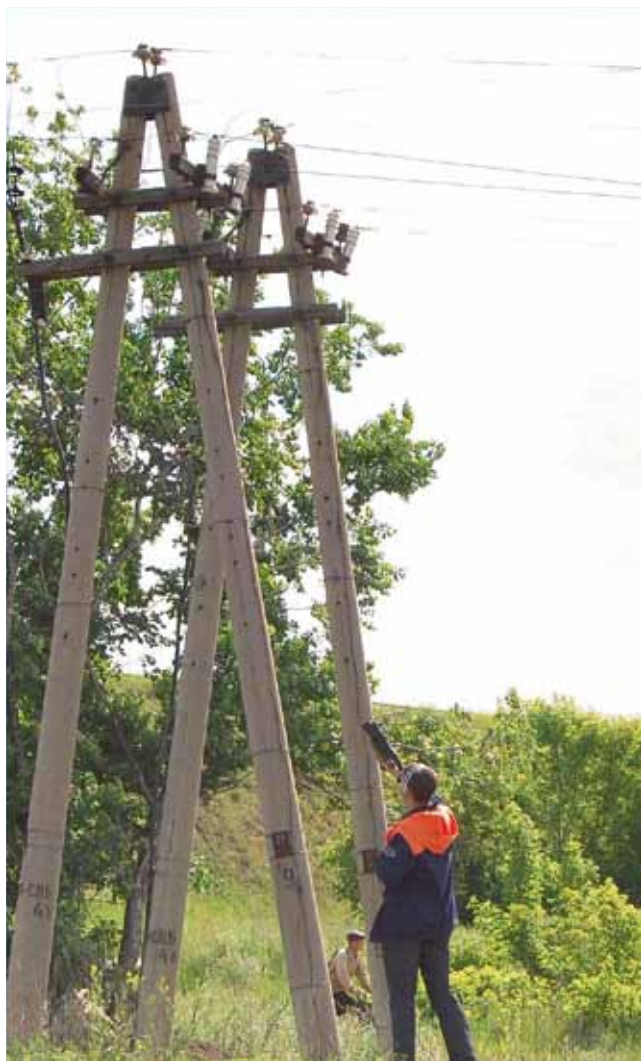
Рис. 2. Поиск неисправностей с помощью прибора «Ультраскан-2004» на ВЛ 6–10 кВ
