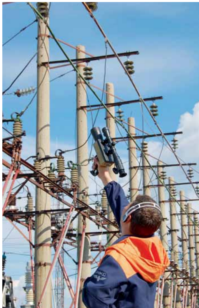
Рис. 3. Выявление дефектных изоляторов на подстанции
