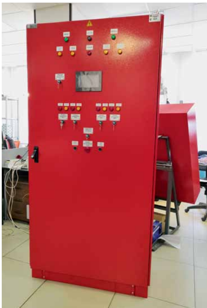
Рис. 1. Шкаф управления насосами пожаротушения «ГЕФЕСТ-СПТ»
