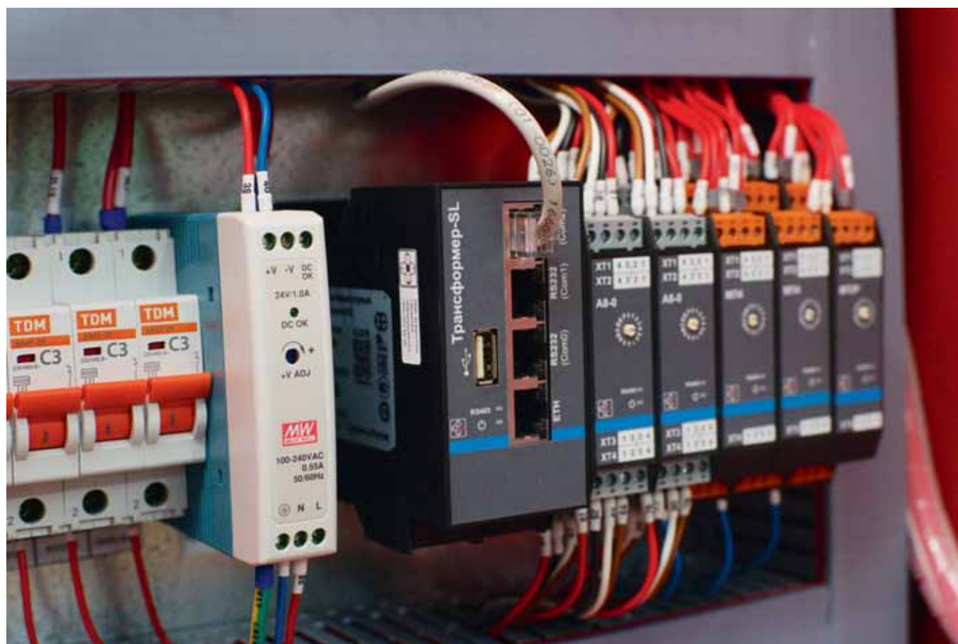
Рис. 2. Контроллер «Трансформер-SL» в шкафу управления
