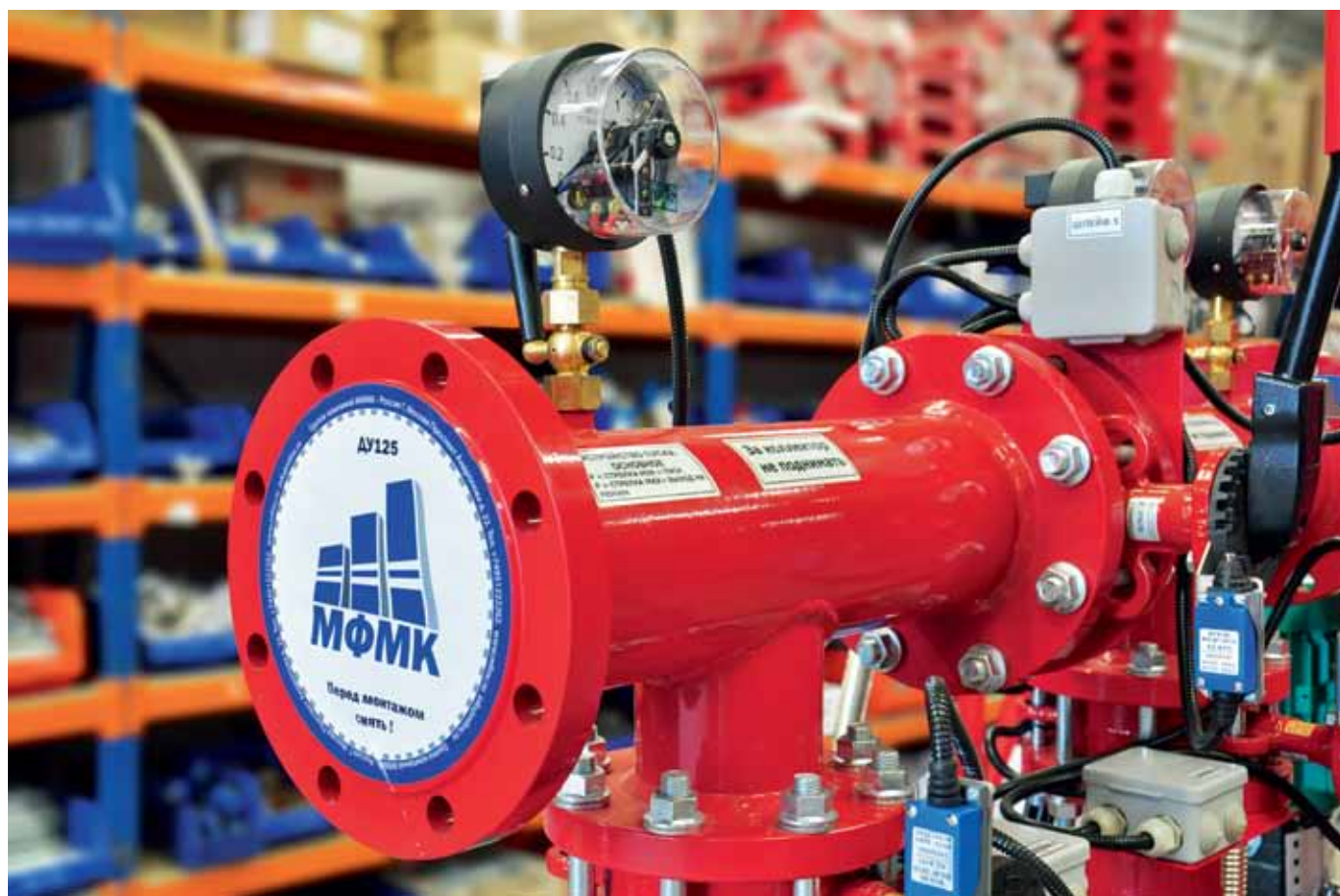
Рис. 3. Напорный коллектор и электроконтактный манометр пожарной насосной станции «ГК МФМК» с фирменным логотипом
