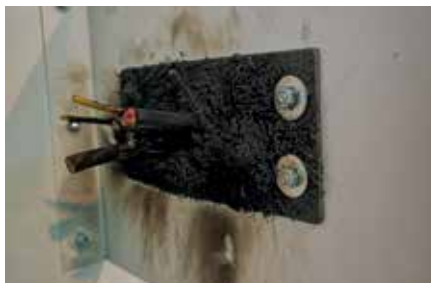
Рис. 14. Вид прокладки IFPS после воздействия огня
