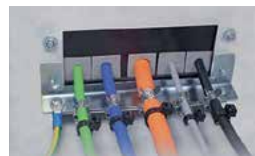
Рис. 10. Пример ввода кабелей в шкаф с использованием зажимов заземления icotek
