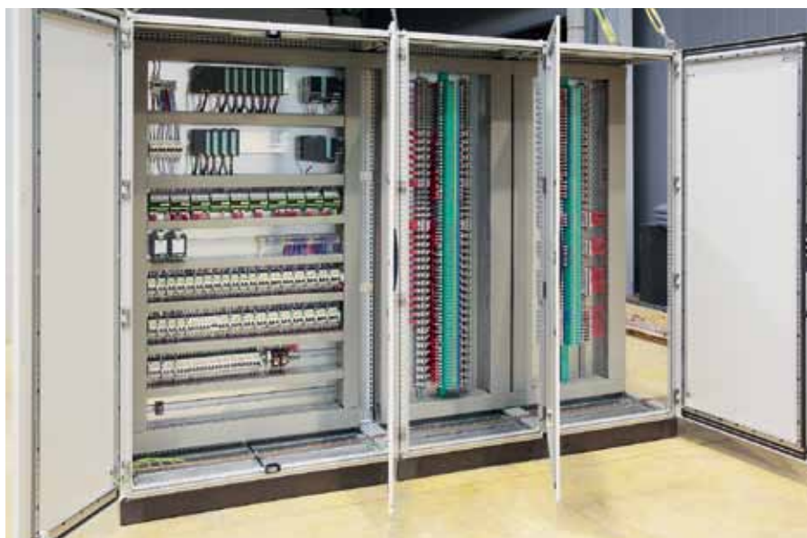
Рис. 2. Пример выполнения работ по изготовлению шкафов автоматизации, мониторинга и управления
