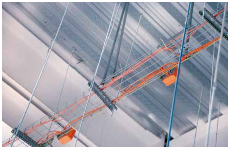
Рис. 1. Огнестойкие кабельные линии «Vulcan»
