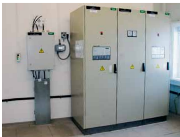
Проект для энергосистемы страны. СОПТ и ШОТ для систем собственных нужд подстанций
