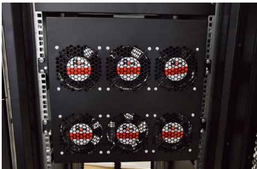
Рис. 6. Вентиляторы, установленные вертикально на кронштейнах
