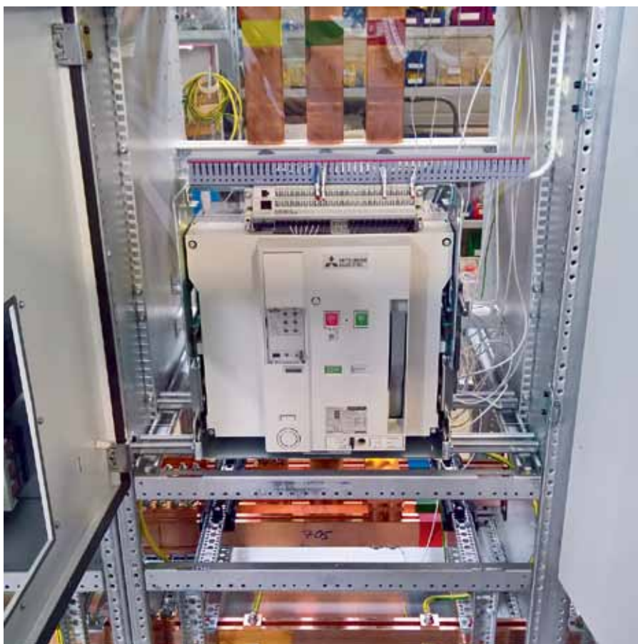
Рис. 7. Пример использования низковольтной коммутационной аппаратуры Mitsubishi Electric
