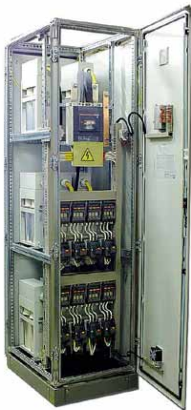
▲ Установка компенсации реактивной мощности
