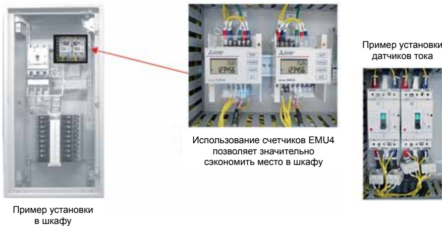
Рис. 8. Установка счетчика электроэнергии EMU4 в шкафу
