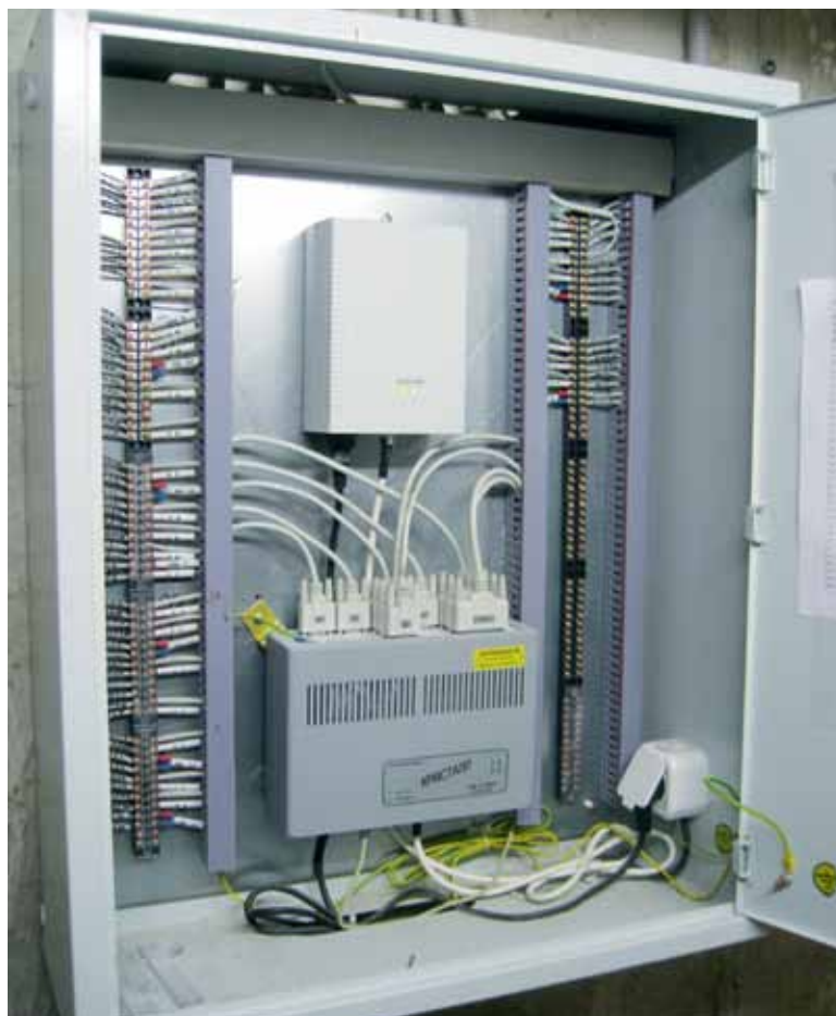
▲ Щит распределительный диспетчеризации с оборудованием комплекса «Кристалл»
