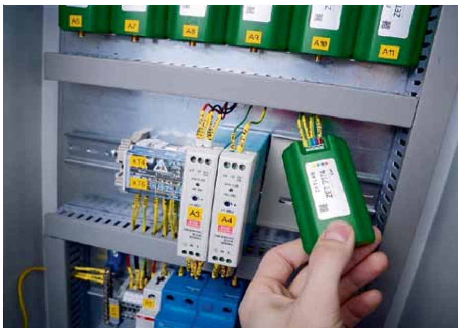
Рис. 3. Модули ZETSENSOR в электротехническом шкафу ZETLAB
