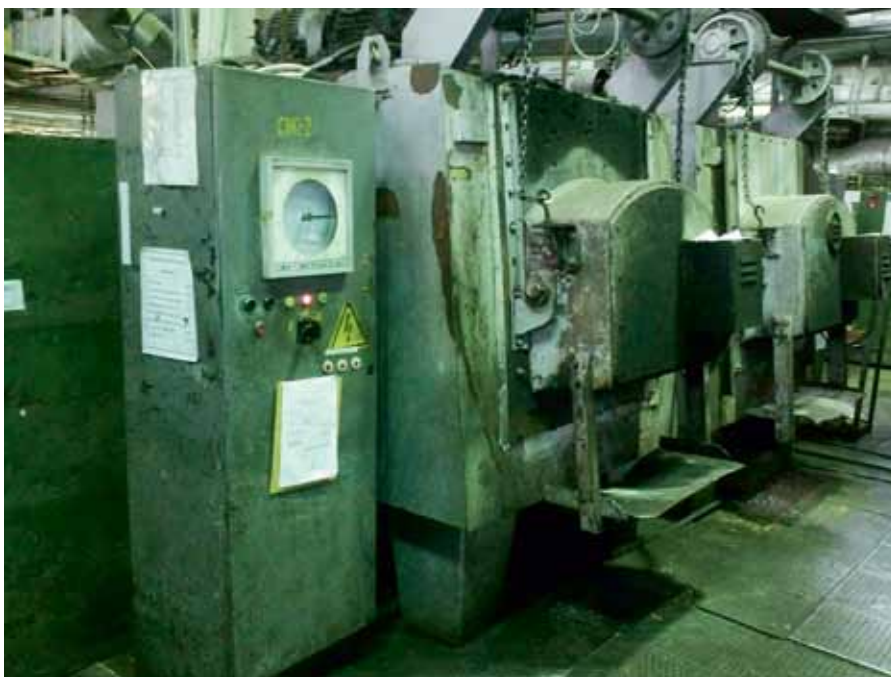
Рис. 1. Печь термообработки со шкафом управления
