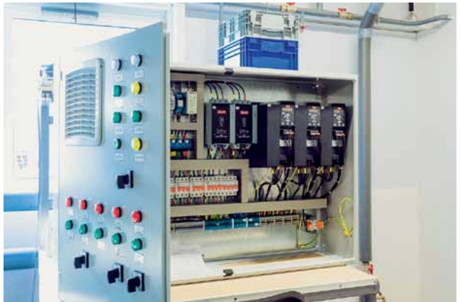
Рис. 3. Щит управления насосной станцией
