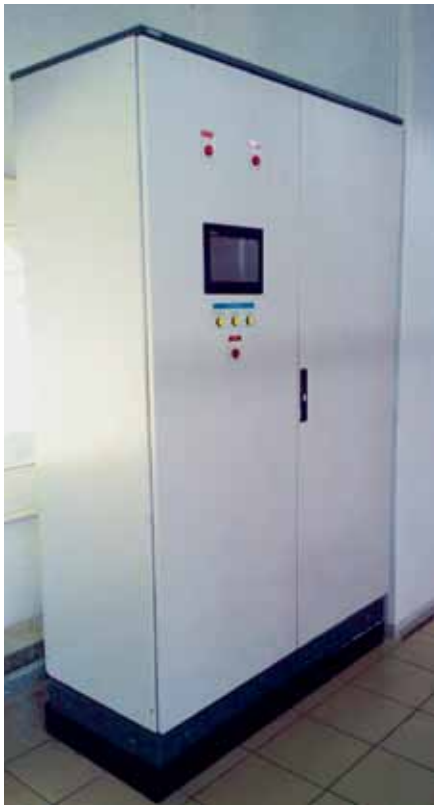
Рис. 4. Шкаф управления ШУ-Е-12 с панелью оператора
