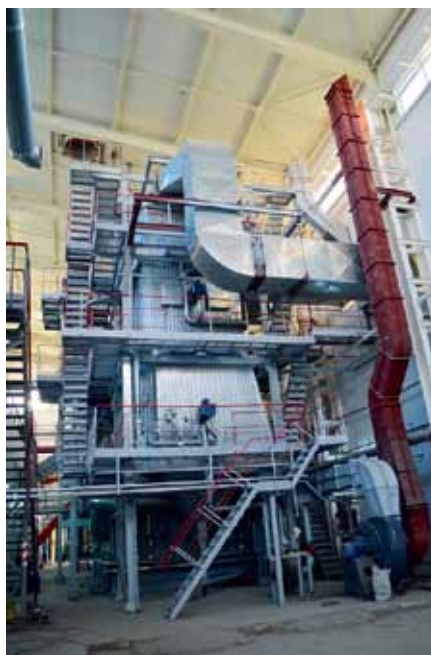
Рис. 1. Паровой котел Е-12-1,4Р в котельной предприятия
