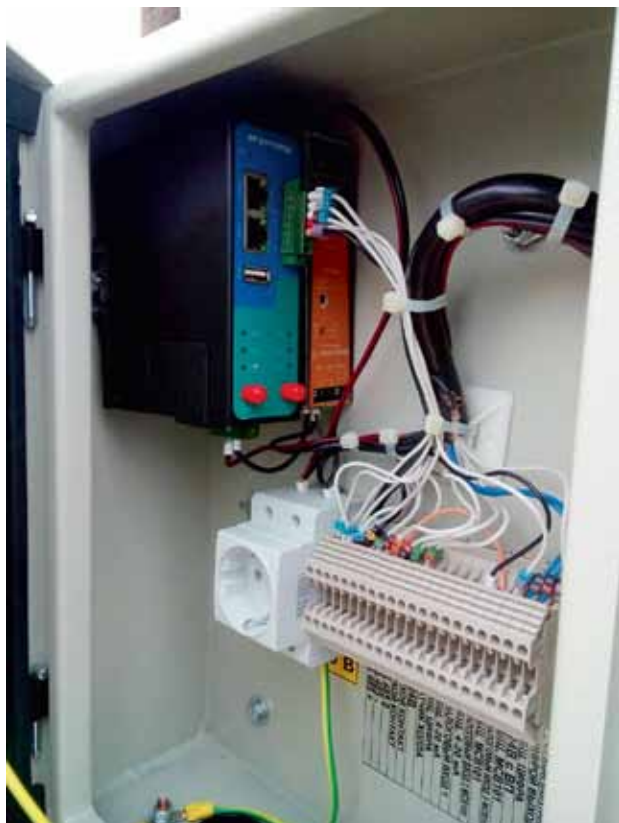
Рис. 3. Robustel R3000-3P в шкафу автоматизации
