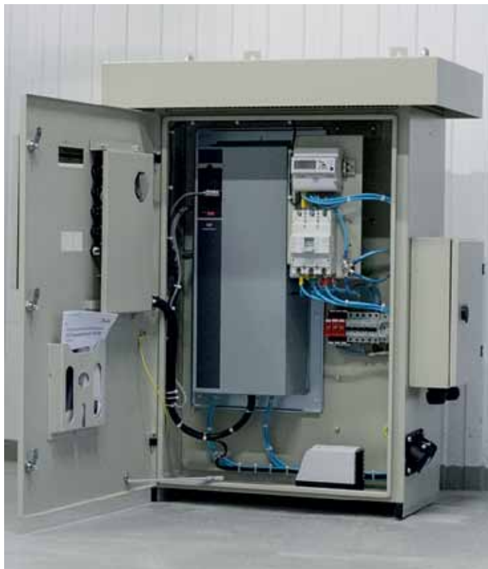
Рис. 4. Станция VLT SALT: шкаф управления
