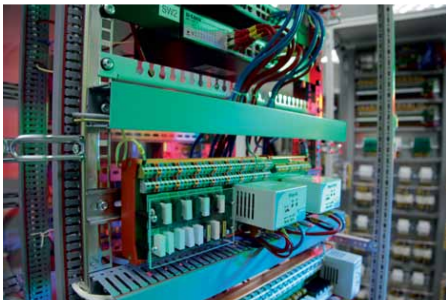
Рис. 3. Модули MIRage-N в шкафу
