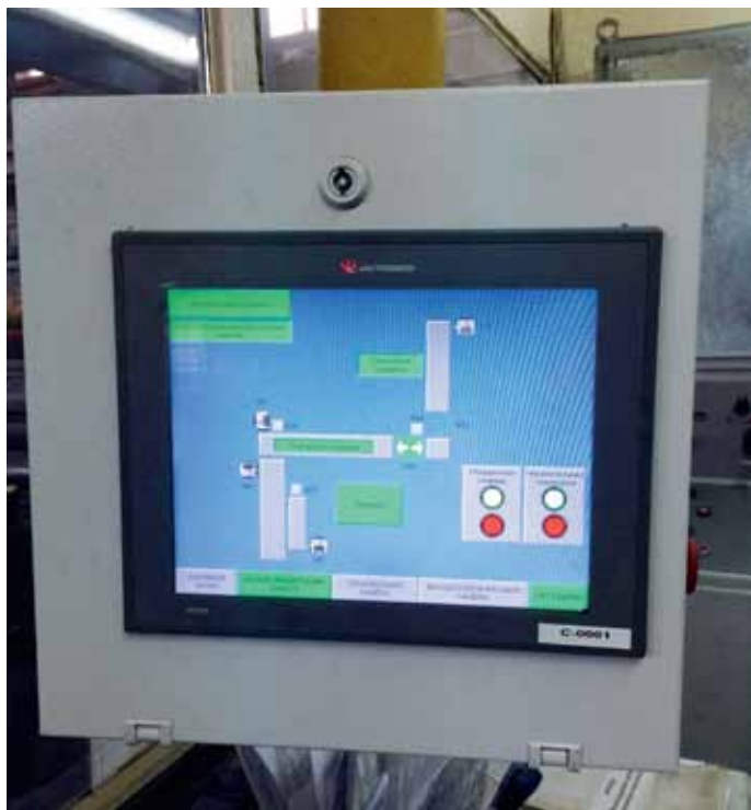
Рис. 1. ОПЛК Unitronics Vision 1210 обладает функциональностью, которая позволяет ему выполнять роль единого пульта диспетчера
