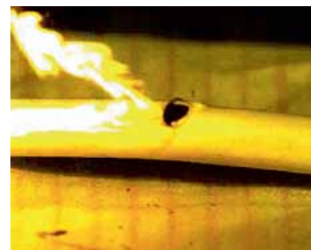
▲ Дуговой пробой в электропроводке
