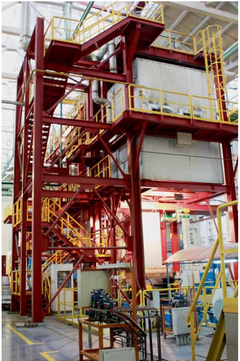
Рис. 1. Современное производство — такой сложный процесс, что без диспетчеризации на базе SCADA его уже невозможно представить
