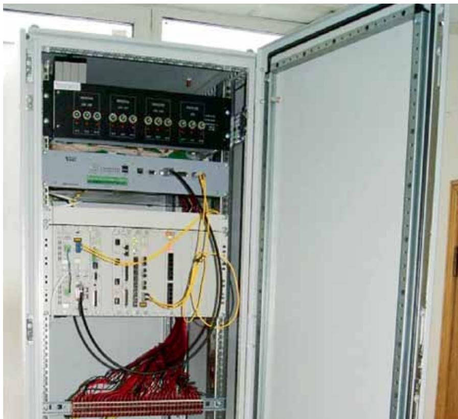
▲ Комплекс оборудования систем передачи технологической связи, телемеханики, команд релейной защиты и противоаварийной автоматики «НАТЕКС»
