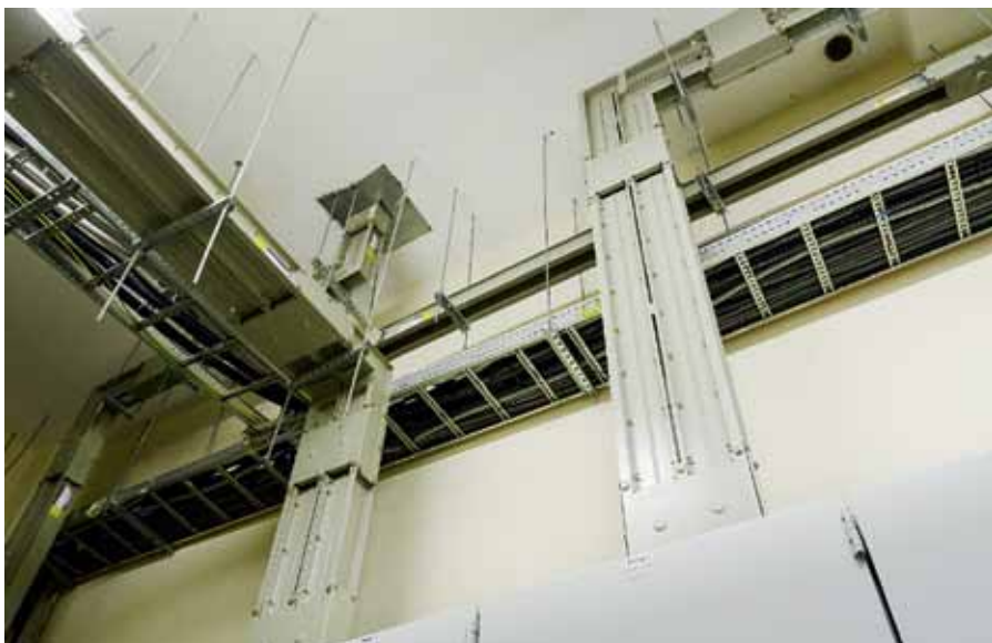
Рис. 5. Блоки шинопроводов, установленные опорно-подвесным способом в здании торгового комплекса
